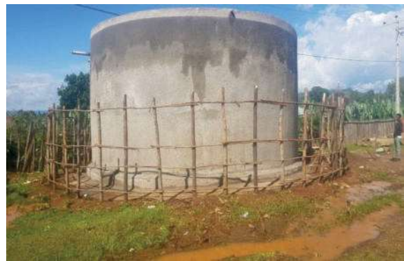
250 m 3 Vorratsbehälter aus Beton
